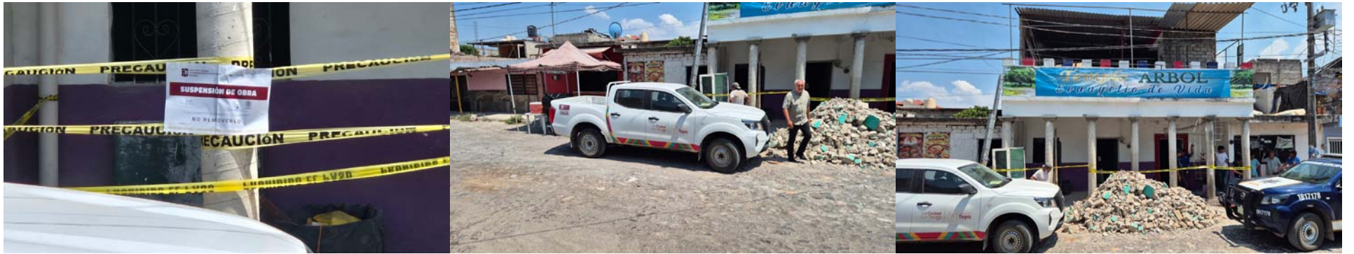
Colapsa techo con albañiles adentro
